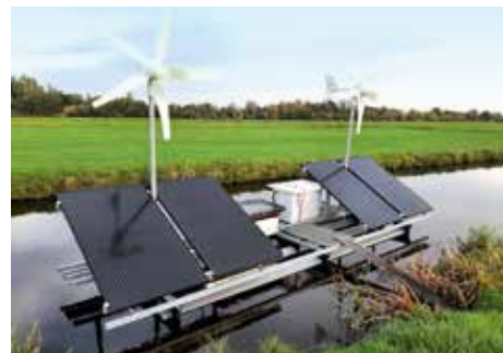
Voor het monitoren van broeikasgassen en het bedienen van schuiven voor de infiltratie van slootwater en het aflaten van regenwater wordt zonne- en windenergie ingezet.
