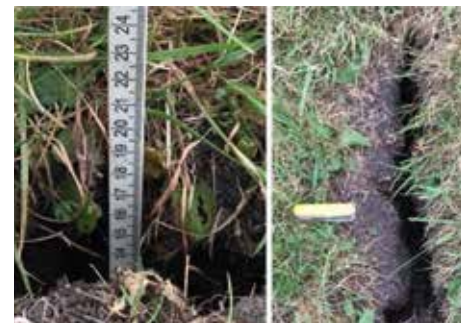
Scheurvorming in de toplaag van het veen op het referentiedeel (augustus 2022). De diepte van de scheur is minstens 19 cm. Lengte van het zakmes: 9 cm.
